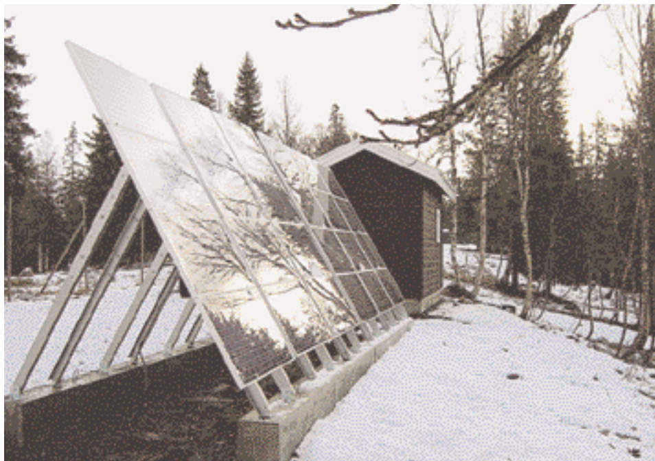
Andra lösningar man arbetar med är till exempel hybridanläggningar med bland annat solpaneler som kopplas till kraftiga batterier, som här vid Ottsjölägret Kalls sameby, där man använder 2,4 KW solpaneler.
